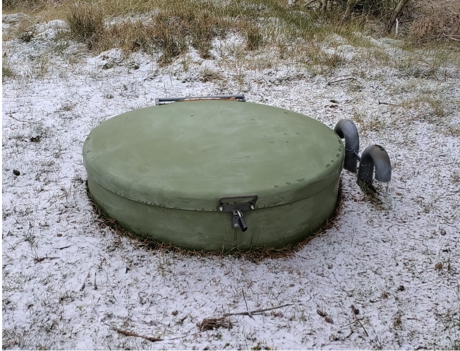
Figur B-1-0-2 Boringerne er placeret i underjordiske glasfiber-tørbrønde og er i god stand. Monteret med lås, men ikke med alarm til evt. indbrud eller hærværk.
